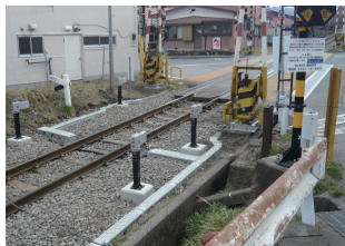
① 障害物検知装置（小舟山踏切）
